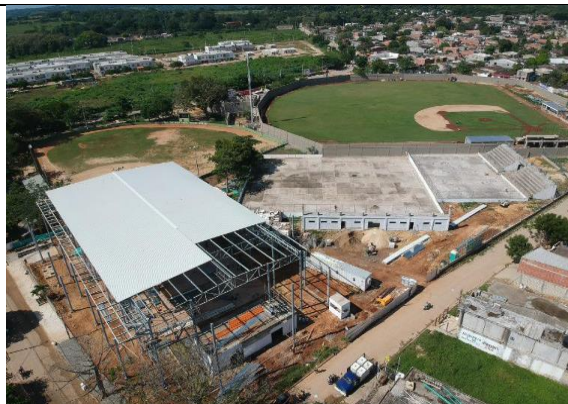
Foto de escenario de tejo a septiembre 28 de 2019 Fuente: Registro Fotográfico Interventoría.
