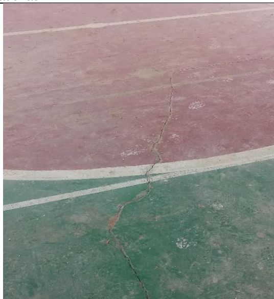
Foto 27. Fisuras placa cancha múltiple.
