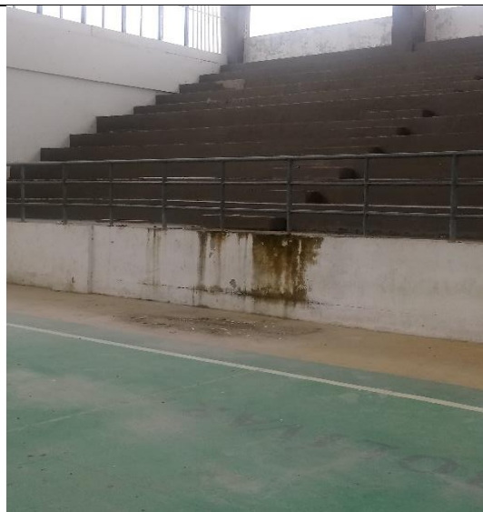
Foto No.30. Humedad o goteras cubierta graderías zona de multicancha.
