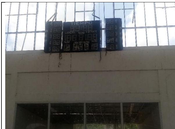
Foto No.23. Estado actual del tablero
