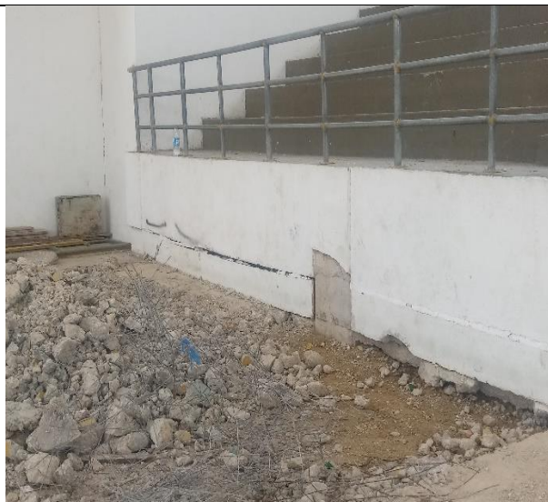
Foto No.29. Fisuras muro perimetral multicancha.
