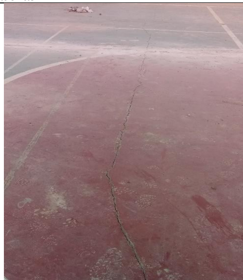
Foto 28. Fisuras placa cancha múltiple.
