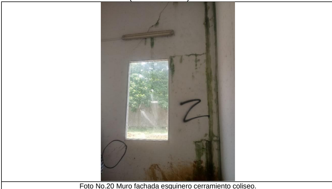
Foto No.20 Muro fachada esquinero cerramiento coliseo.
