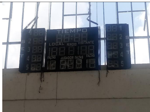
Foto No.24. Estado actual del tablero
